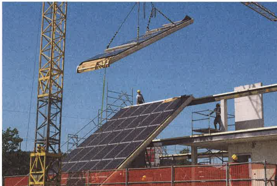
Speziell an der Anlage sind die Solarpanels, welche gleichzeitig die Dachfunktion übernehmen.
